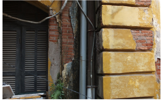
Ảnh 2 - Xuống cấp của hệ thống thoát nước mưa và tình trạng thực vật mọc bám trên tường với rễ có thể ăn sâu vào mạch vữa gây nứt tường
